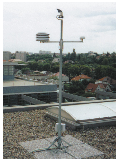
MS s čidly na střeše (Pražská energetika, a.s.)
